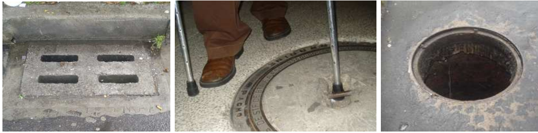
Figura 14. Alcantarillas, obstáculos peligrosos
